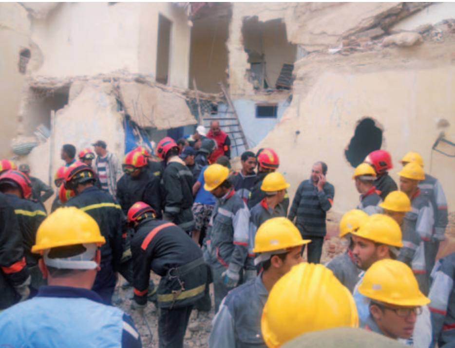
Maisons effondrées à Fès (Maroc), avec intervention conjointe des services volontaires et de la protection civile en octobre 2010. Source : A. Dahmani
