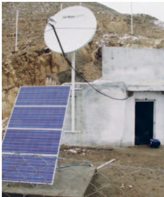
Une station de surveillance sismique dotée d'une liaison haut débit par satellite à Shartuuz, Tadjikistan. Source : PMP International, Tadjikistan
